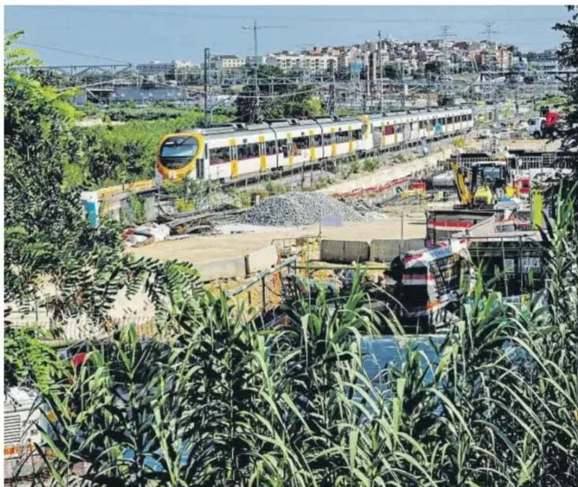
Un tren de Rodalies circula junto al socavón, a la altura del barrio barcelonés de Vallbona
